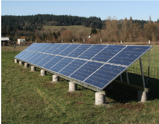
Figura 1: pannelli fotovoltaici rigidi ancorati con pilastri in cemento
