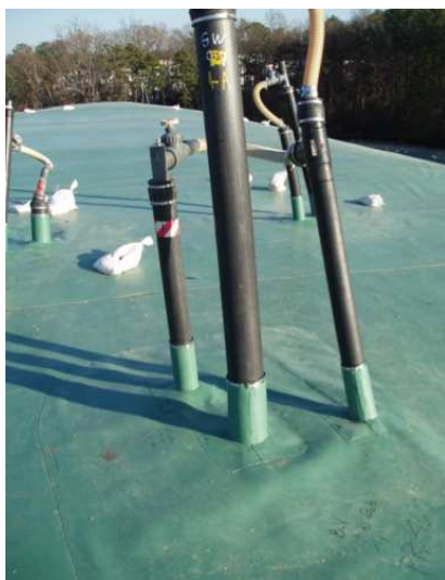
Figura 29: Impianto di Tessmann Road (US-TX): particolare delle saldatura attorno ai tubi del biogas
