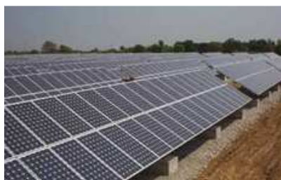
Figura 16: Impianto fotovoltaico discarica di Oleggio (NO)
