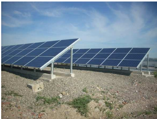
Figura 3: pannelli fotovoltaici rigidi ancorati con basamenti continui in cemento. Impianto di Castelceriolo (Al)
