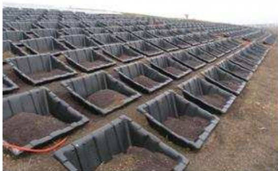
Figura 19: Impianto di Roncayette (PD): vasche per i pannelli fotovoltaici zavorrate
