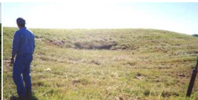
Figura 14: cedimenti differenziali in una discarica in Ohio (USA)
