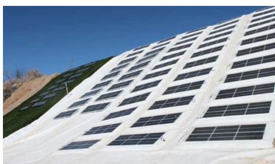
Figura 11: impianto a pannelli flessibili
