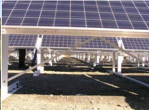
Figura 2: pannelli fotovoltaici rigidi ancorati con infissioni
