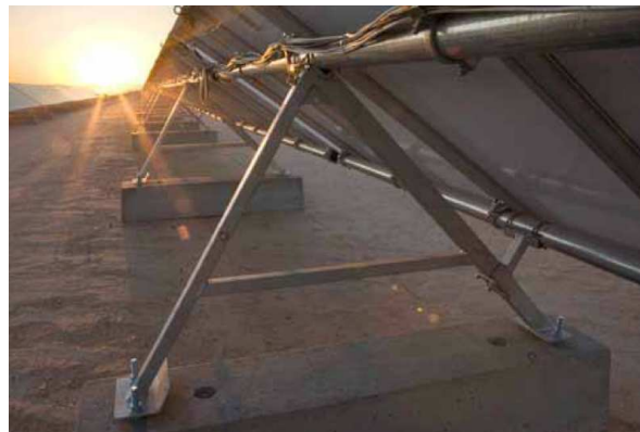
Figura 4: pannelli fotovoltaici rigidi ancorati con zavorre in cemento
