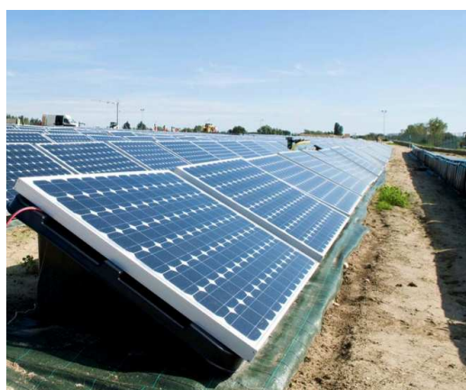
Figura 20: Impianto di Roncayette (PD): impianto installato
