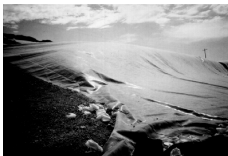
Figura 32: Esempio di sollevamento di geomembrana a causa del vento
