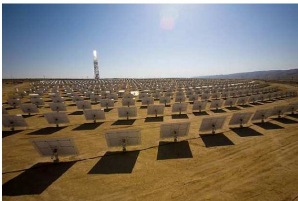
Figura 9: CSP a torre centrale
